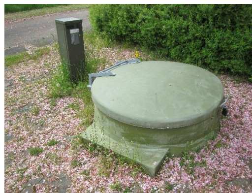
Indvindingsboring tæt på Avedøresletten
